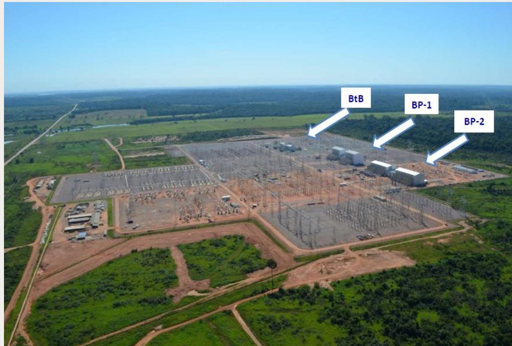
Porto Velho Substation
